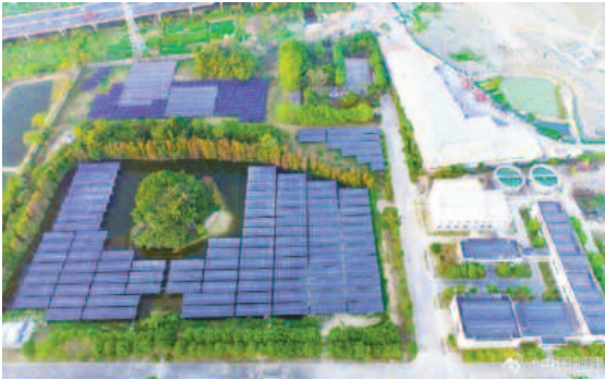
Công ty TNHH Nhiệt điện tỉnh Quảng Đông với hệ thống mái nhà quang điện tích hợp đồng bộ.
