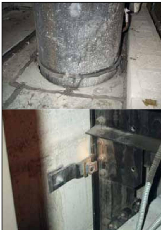
Hình 11.2 - Phá hoại bám dính giữa keo và sàn (trên) và vết xước trong ray dẫn hướng thang máy (dưới) do chuyển dịch xuống của kết cấu công trình nhà (90 mm) so với các phần tử phi kết cấu (Bast và cộng sự 2003) [25] .
