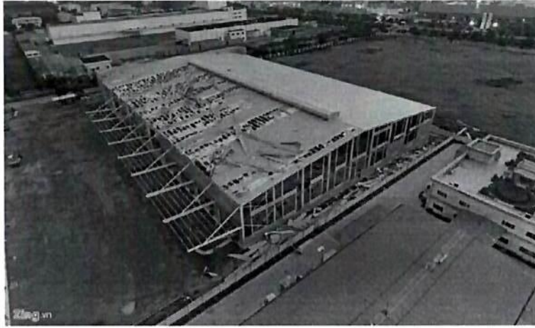
Hình 5. Hệ mái của công nghiệp bị phá hoại do lốc xoáy gây ra tại huyện Yên Phong - tỉnh Bắc Ninh (28/7/2016)
