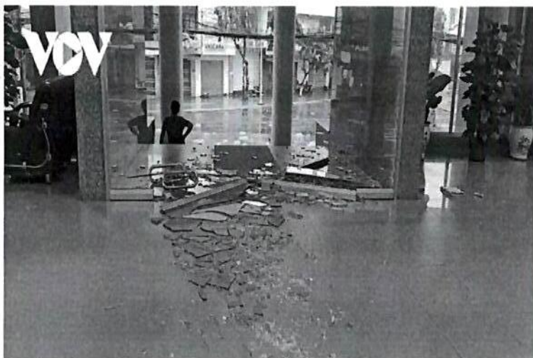
c) Hệ cửa kính bị phá hoại sau cơn bão số 9 (năm 2020) tại Quảng Ngãi
