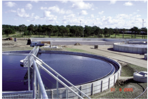
Các bể lọc trong một cơ sở xử lý nước thải
