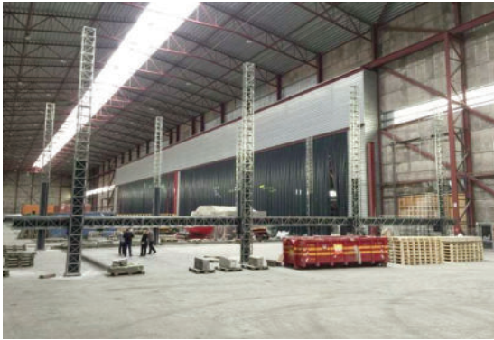
COBOD đã sản xuất một máy in 3D lớn cho một công ty Ả Rập Saudi, có thể in một tòa nhà gần 280m 2
